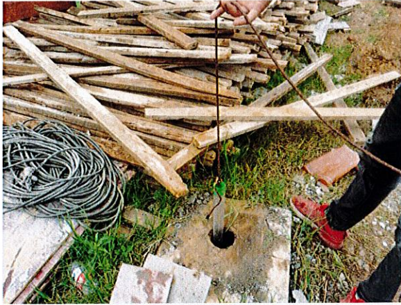
1#地下水监测井 (☆1)
